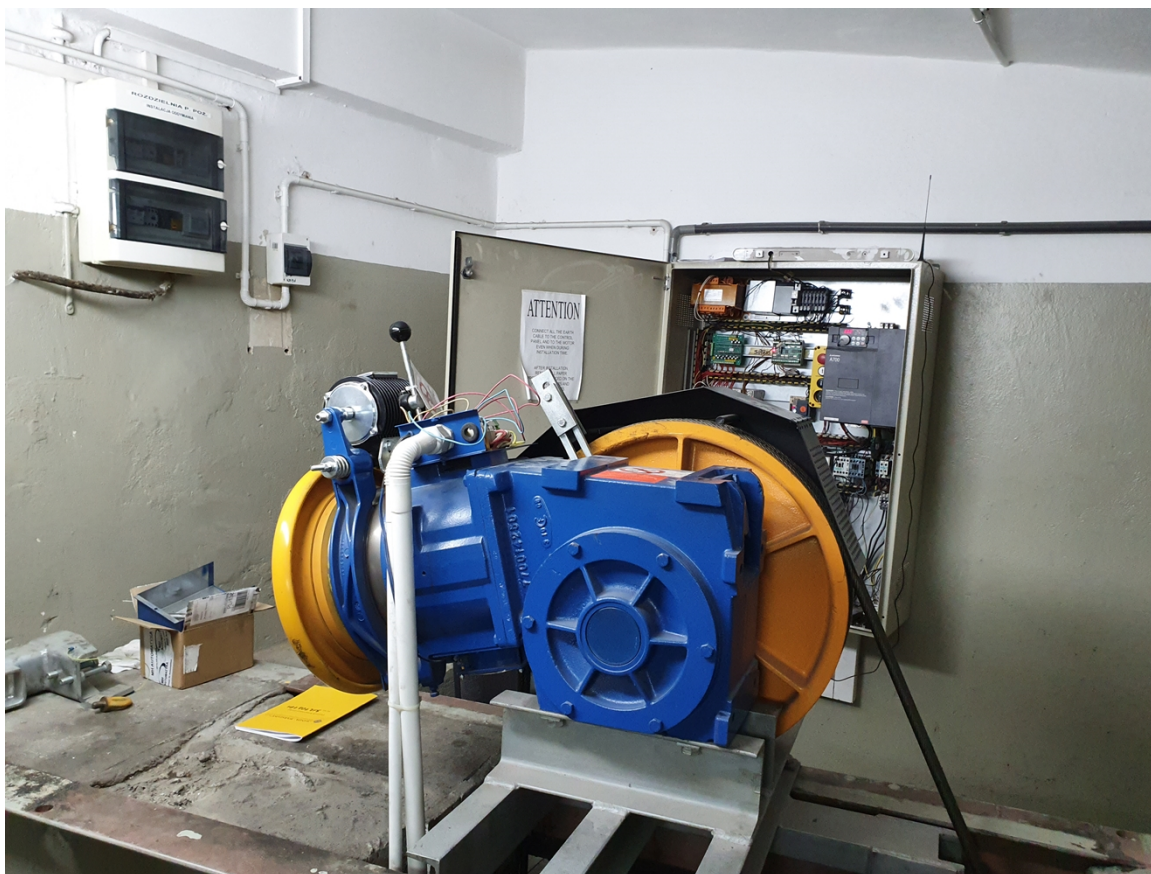
Usytuowanie zespołu napędowego i aparatury w maszynowni
