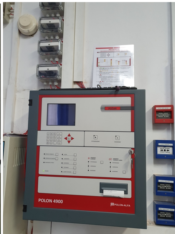
Centrala pożarowa na poziomie parter
